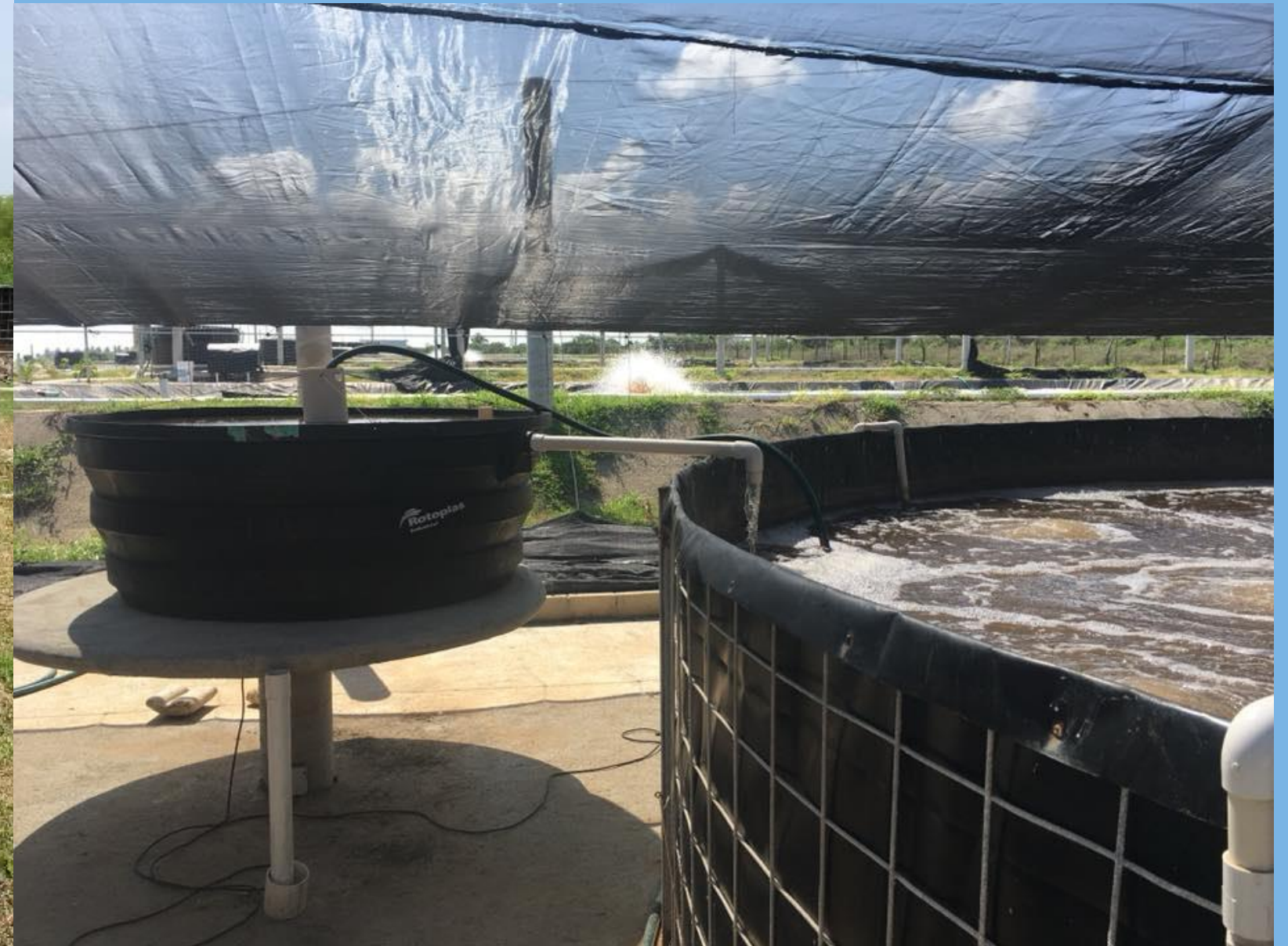
Clarificador Maricultura Vigas
