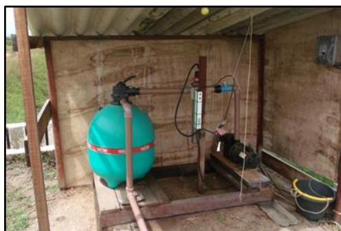
Foto 28 – Uso de filtros de areia em berçários Fonte: MCR Aquacultura Ltda.
