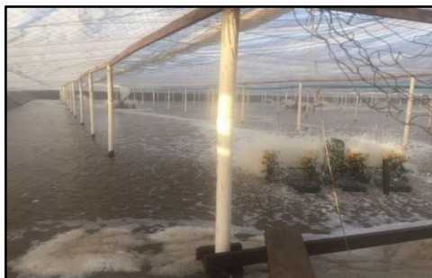
Foto 95 – Viveiros com estruturas de coberturas em madeira e colunas em PVC Fonte: ABCC.
