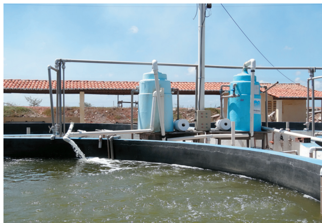
Figura 5. Clarificador (A) e fracionador de proteína (B), empregados para controle de sólidos particulados e dissolvidos na água.
