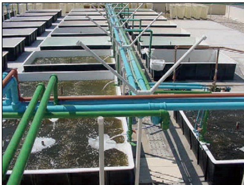
Foto 5: Tubulações de Aeração, Alimentação.
