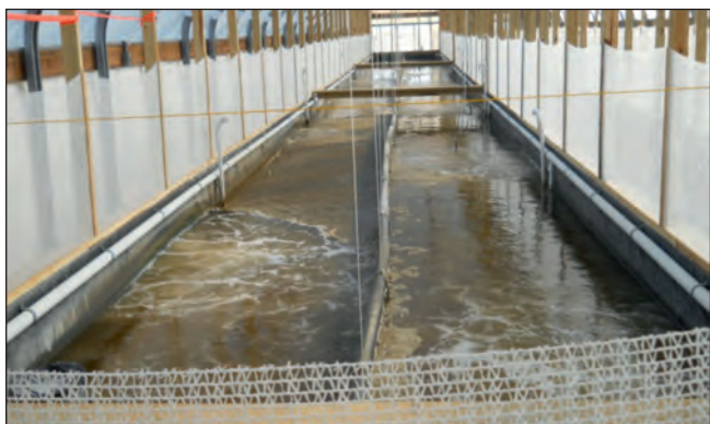
Raceway de 100m 3 operado com sistema Taeration®.
